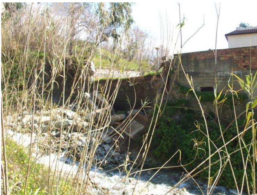
Foto 11. Si noti il muro di cinta crollato dallo scalzamento al piede
