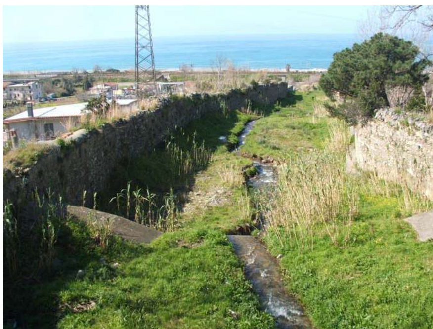
Foto 2. Torrente Licciardo. Vecchi muri di confinamento
